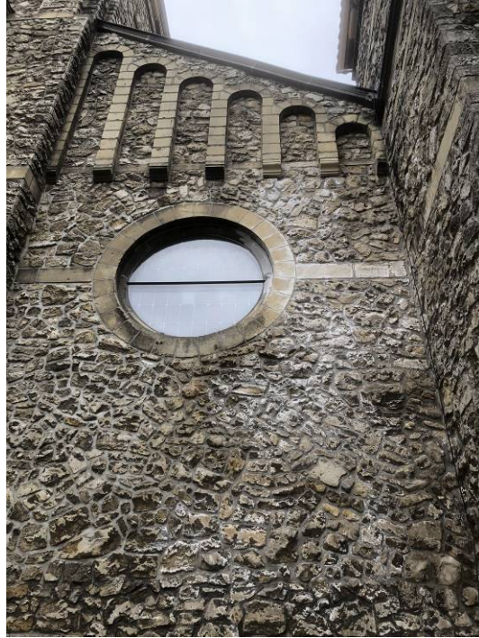
Zoutuitslag in de buitengevel
