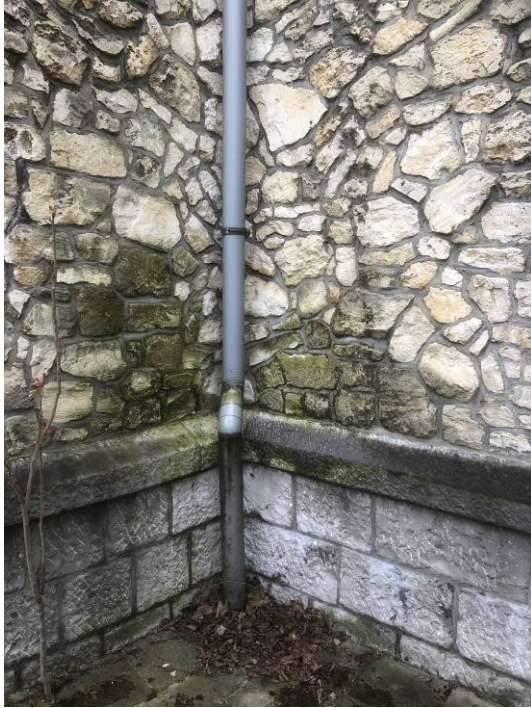
Drijfnapte mergelstenen door een defecte regenpijp
