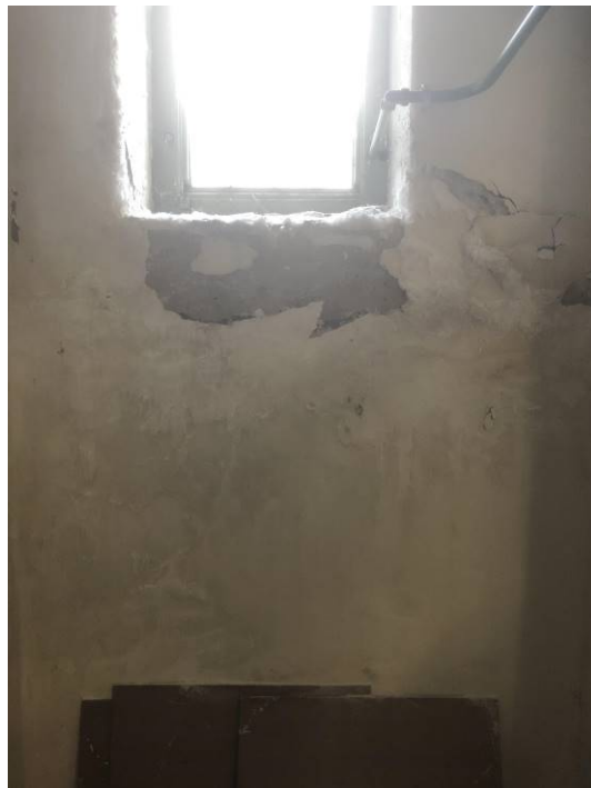
Beschadigingen en zoutuitslag in het souterrain
