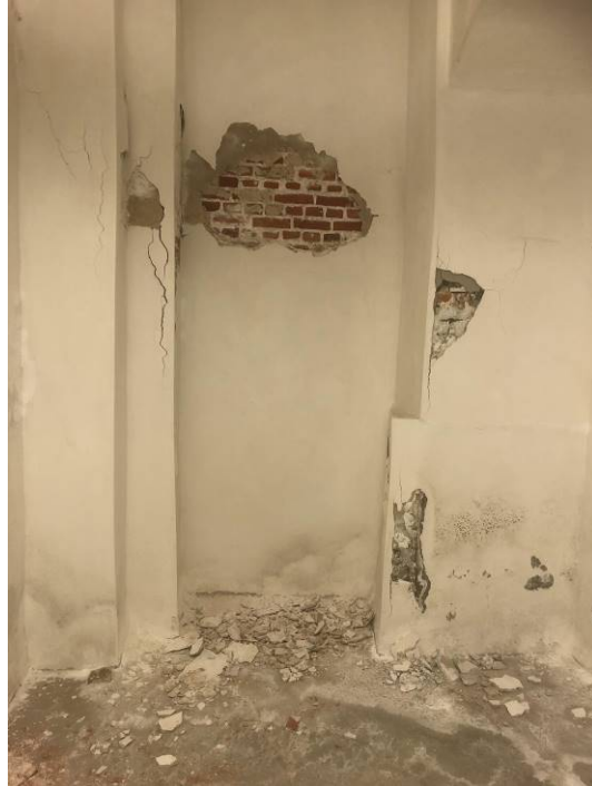
Schade in het souterrain onder de absis
