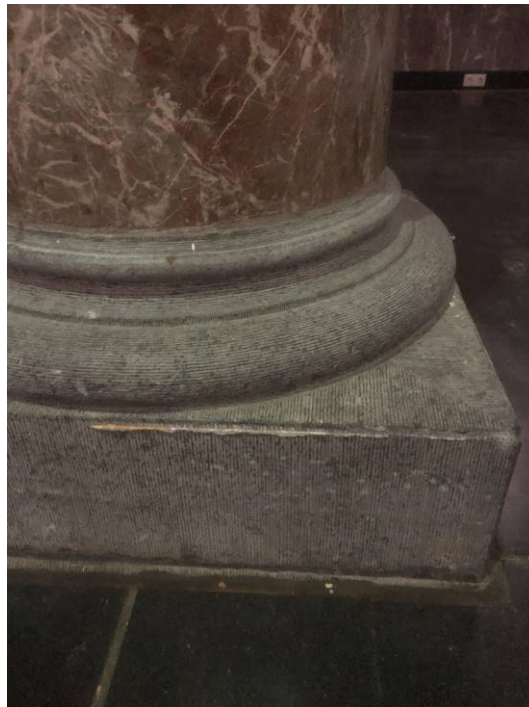
Loszittende platen in het basement van de zuil
